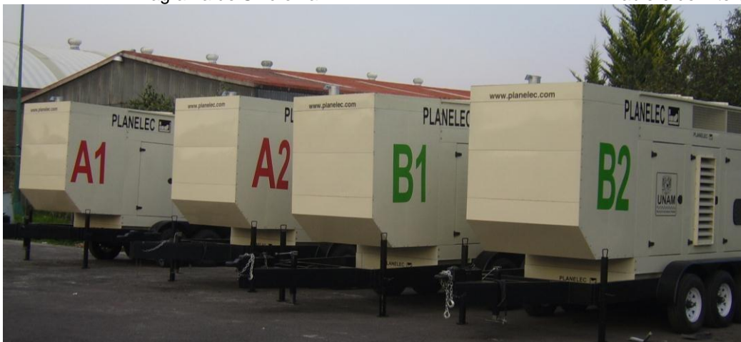
Plantas diesel eléctricas de 500 KW
